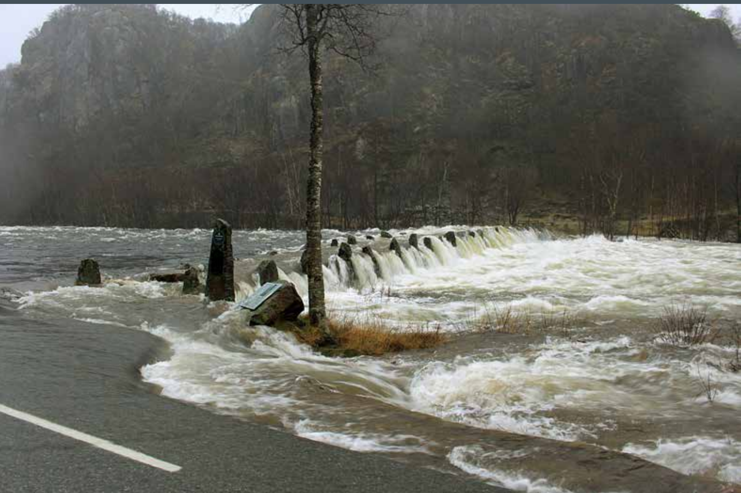
Terland klipp ble overskyllet og sterkt skadet i flommen 5. desember 2015. (Foto: Tormod Eikeland)
