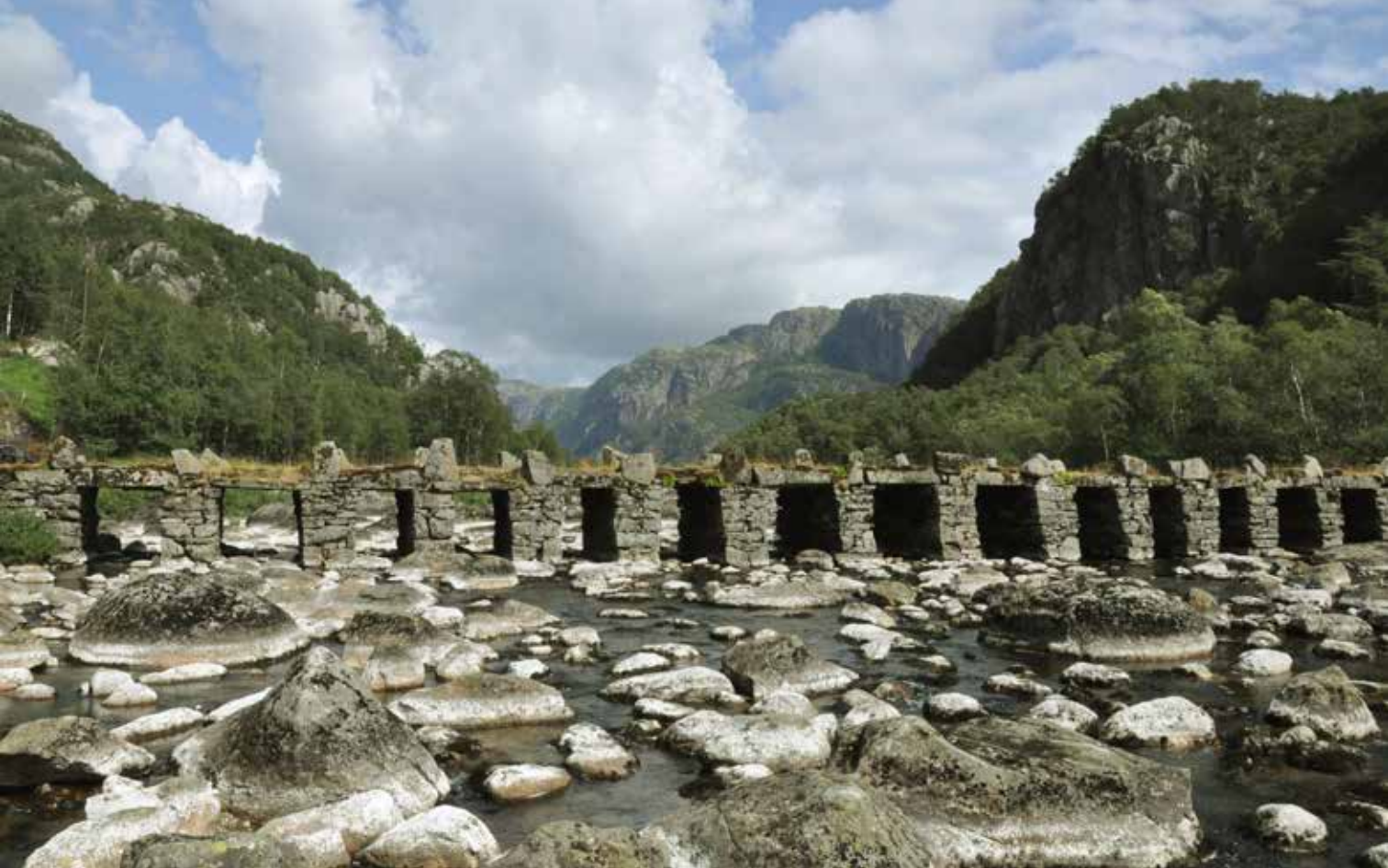
Teland klopp ligger inn mot Sirdalvegen mellom Tonstad og Eigersund, og er med sine 60 meter Norges lengste Steinhellebru. (Foto: Håkon Aurlien)
