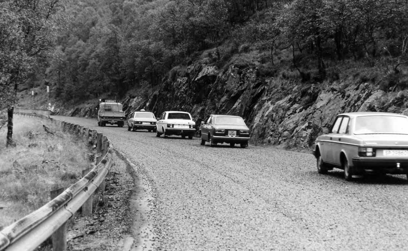
Nylagt ottadekke i Ottadalen 1964, med trafikk bak ledebilen. Det var viktig at man ikke kjørte for fort før ottadekket hadde satt seg, blant annet for å unngå steinsprut. (Foto Torkild Thurmann-Moe)
