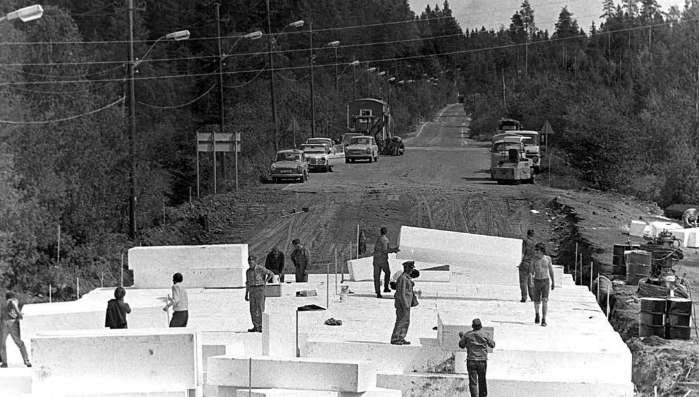
Arbeid med lette fyllinger på Strømsveien i Akershus i juni 1973, med ekspandert polystyren etter Veglaboratoriets oppskrift. Dessverre fulgte man ikke oppskriften med å fylle på nok overdekning. Fyllingen ble for lett og fløt opp ved flom.
