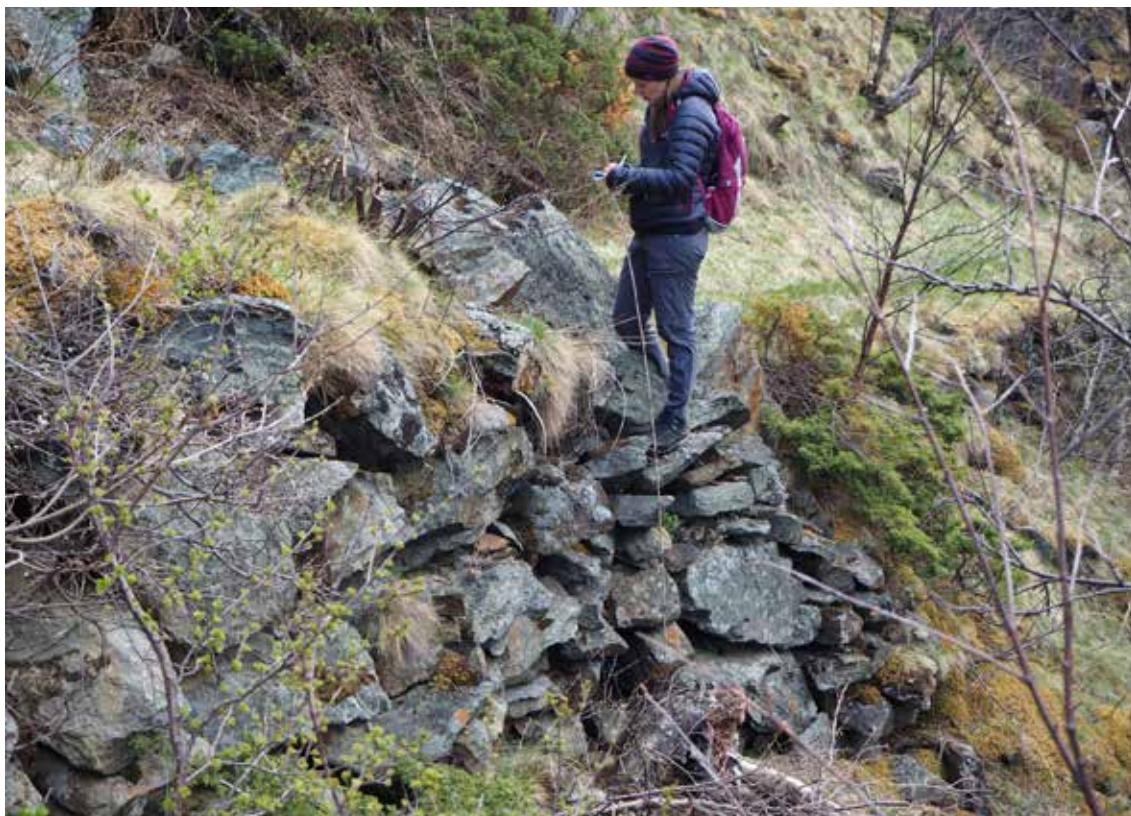
Steinras som har lagt seg over kongevegen frem til ytre vegmur langs Vårstigens søndre del. Foto: Izabela Chlewicka
