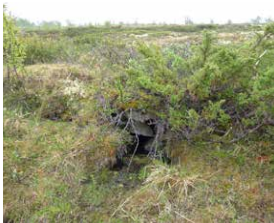
Stikkrenne som er synlig i vestre oppbygning på kongevegen som går over myra sør for Fokstua.
