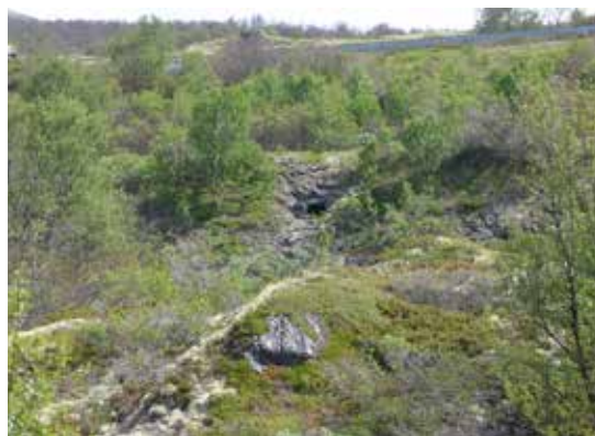
Steinsatt stikkrenne på tidligere riksveg/hovedveg nedenfor E6. Autovnet ved E6 synes øverst i bilde. Foto: Marit Johansson
