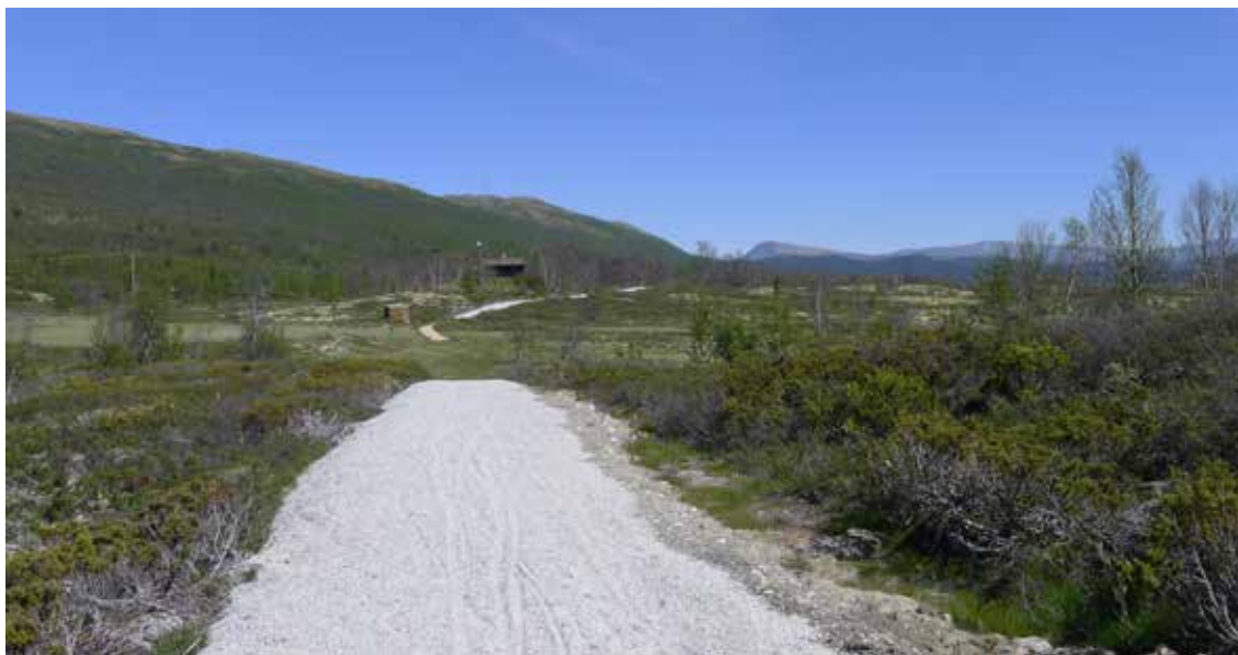
Nyanlagt sykkelveg som følger sykkelvegen mellom Dovregubbens hall og Heggingsbakken. Foto: Marit Johansson
