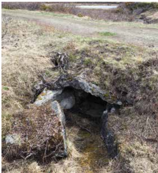
Tørrelagt stikkrenne på Kongevegen over Hjerkinnhø. Foto: Izabela Chlewicka
