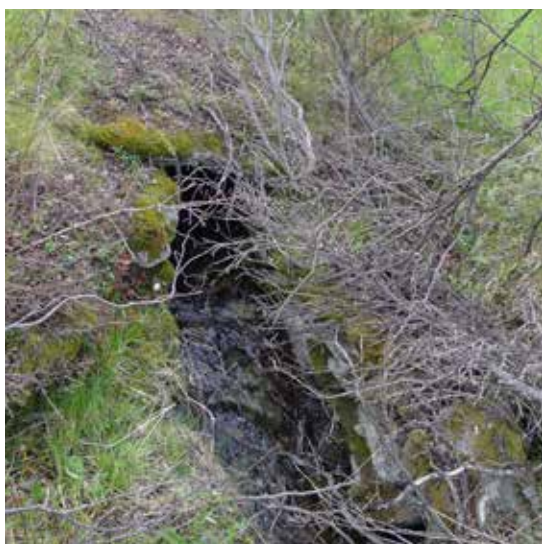
Bildet viser en del av kongevegen øst for E6, mellom Kongsvold og Jørskloppa, hvor det ligger en helle over en oppmurt bekk. Foto: Marit Johansson
