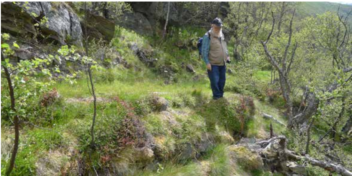
Geir Paulsrud ved Norsk vegmuseum, Statens vegvesen konstaterer skader og restaureringsbehov langs Vårstigen. Foto: Marit Johansson
