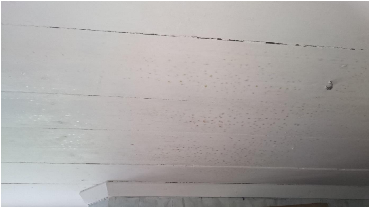
Taket i receptionen på nedervåningen. Till vänster i bild syns de blankare/oljiga fläckarna. Till höger de kraftigare mer oljiga och brunaktiga fläckarna.
