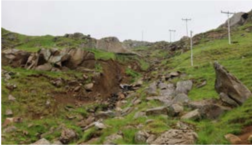
Her er deler av den gamle vegen forsvunnet i en kløft som er dannet av utraste steinblokker og vannerosjon. Ei av steinblokkene ligger ytterst på kanten. (Foto: Håkon Aurlien)
