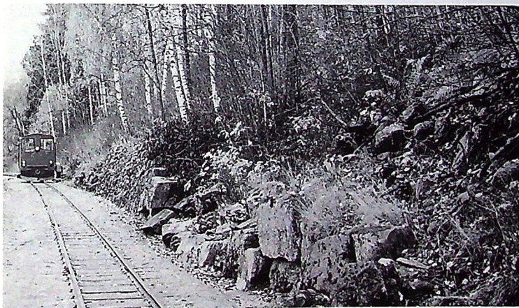
Utrast parti av Småfoss støttemur. Det søkes om prosjektmidler for å få rettet opp denne. Foto: Hans-Erik Bjerke.
