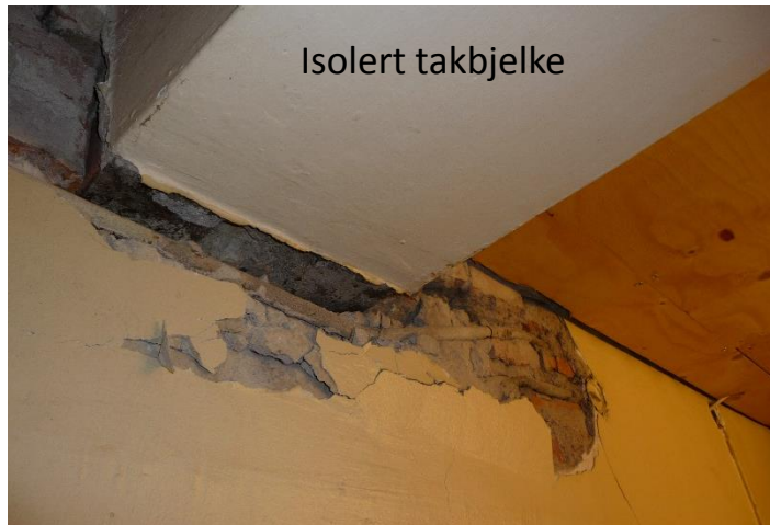
Skader på grunn av bevegelse i huset
