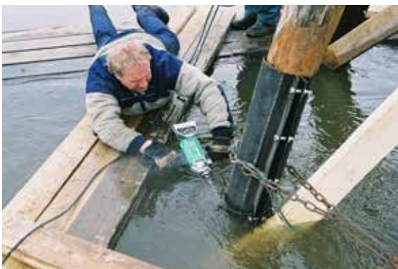
Forberedelse til skråstagsmontering. Håndverkeren borer gjennom stålmuffe og bunnpål. Vannstanden hadde steget, derfor må det bores under vann.
