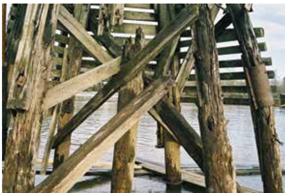
Galge 24A før restaurering. Tilstands-dokumentasjon.
