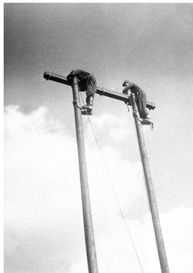
Linjebygging i 1950-åra i Follidal. Her monteres traversen i ei høgspentmast. MINØ.35018.
