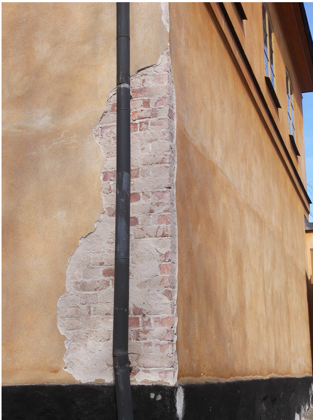
Skada i sydöstra hörnet mot gården. Foto Karin Blent
