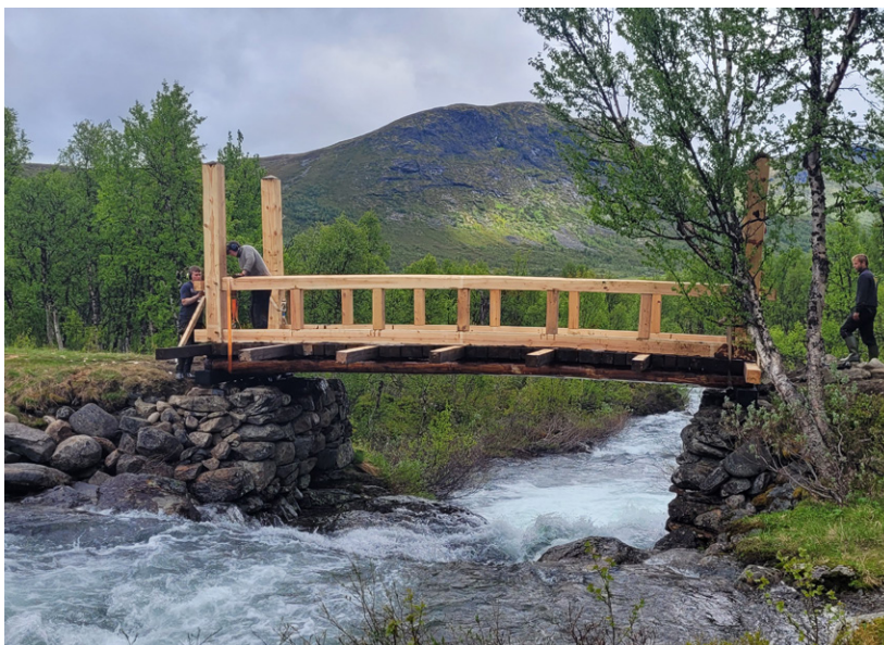
Den nye Sule bru på kongevegen over Filefjell ble montert i juni 2024. Her gjøres de siste arbeidene på rekkverket. (Foto: Ann Kristin Engh)
